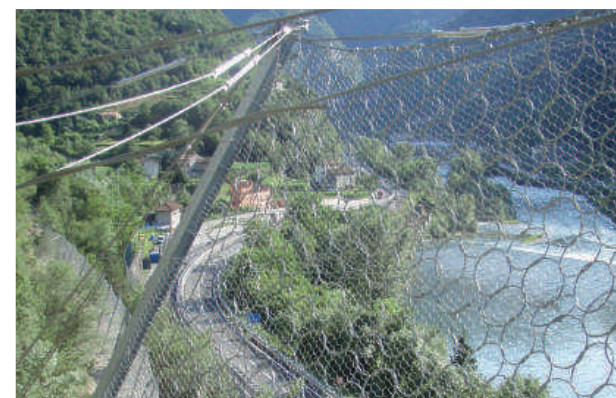
Защита от камнепадов Богучанской ГЭС
