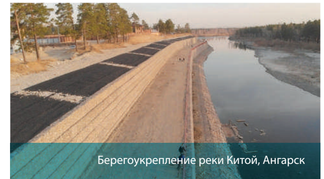
Продольные защитные сооружения вдоль берега реки
