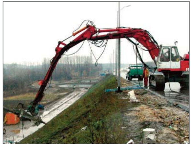
Рис. 10. Использование навесной буровой мачты на обычной строительной технике для бурения с помощью буроинъекционных штанг малых и средних типоразмеров (с внутренними/наружными диаметрами от 30/16 до 52/26) [8]
