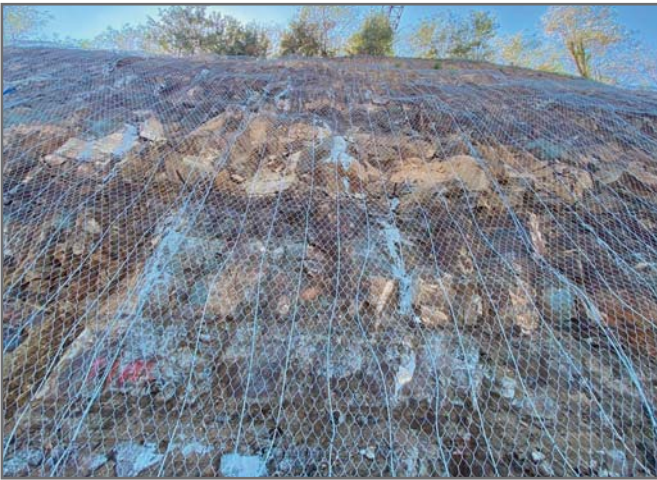
Рис. 6. В случае этой подделки тросы просто наложены сверху на сетку и закреплены сверху анкерами
