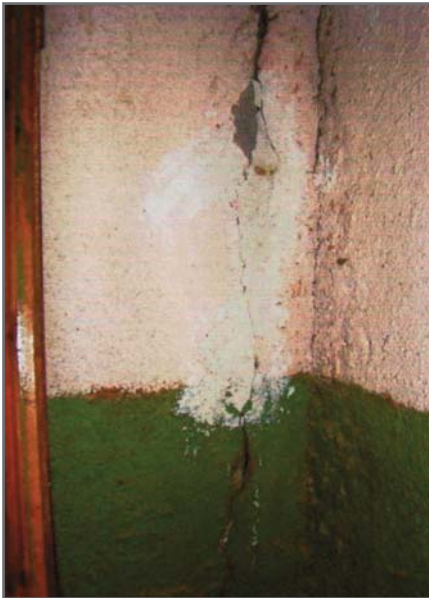
Рис. 3. Трещины в стене и на стыках панелей, проявившиеся сквозь штукатурку и краску
