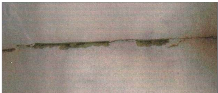
Рис. 2. Трещина между стыками панелей, проявившаяся в квартире через треснувшие обои
