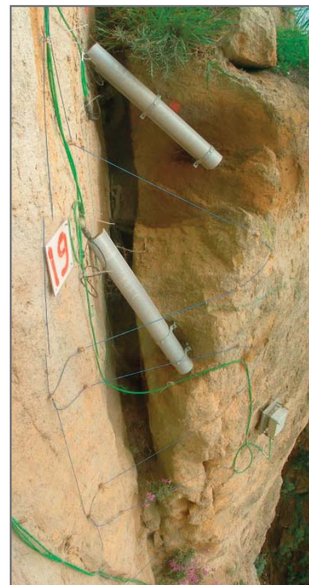
Рис. 11. Установка распределенного оптоволоконного датчика для мониторинга поведения туфового блока № 19
