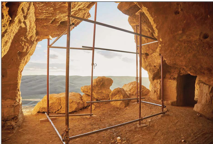
Рис. 22. Подпорно-распорная конструкция у входа в пещеру 3, с кровли которой ранее отвалилось несколько крупных обломков (обломок посередине имеет высоту около 0,5 м)
