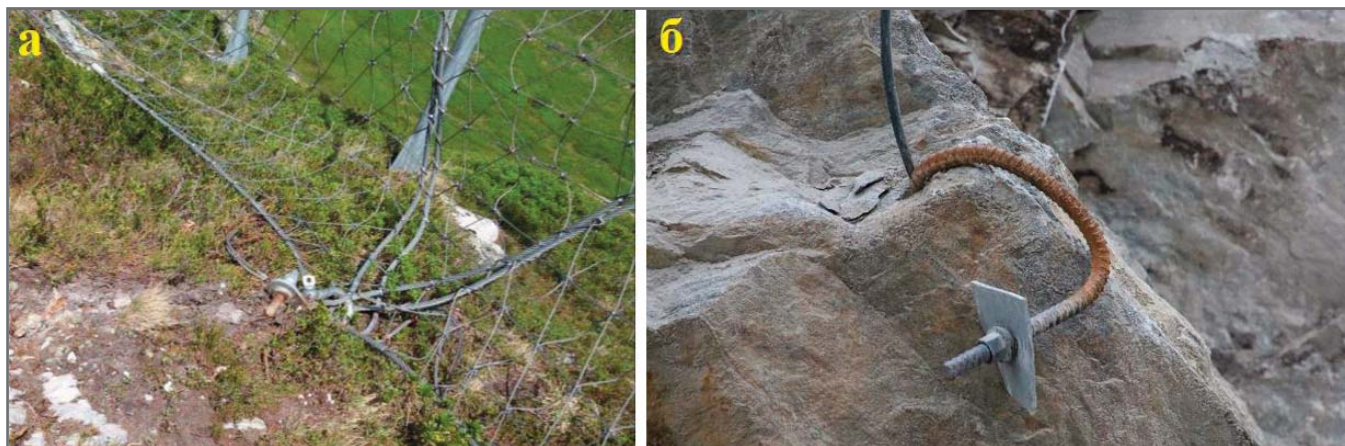
Рис. 3. Сломанный анкерный болт, крепивший боковые несущие тросы полотен снегозадерживающей сетки (а); изогнутый арматурный анкерный болт (б)
